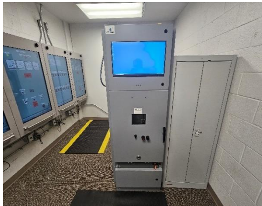
Fig. 7. HV ERS 2 FMS HV breaker.
